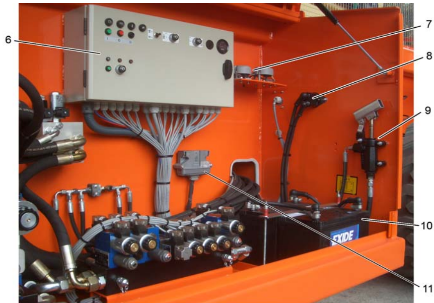
Ventielen en generator
